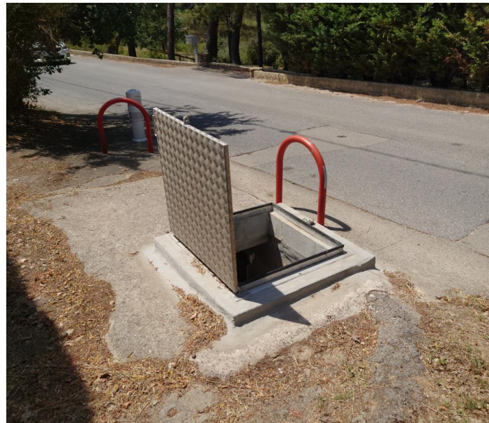
Figure 28 : Vue extérieure du surpresseur Val d'Aren
