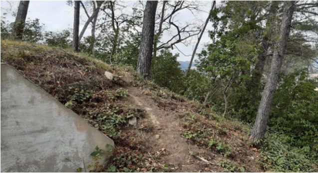
Arbres poussant sur le reservoir du Cas
