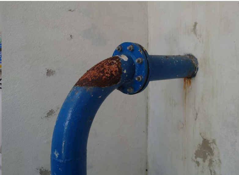
Traces de corrosion de la canalisation de distribution
