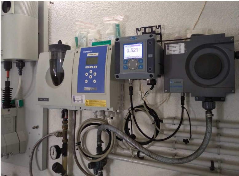
Mesure en continue de la chloration et de la turbidité
