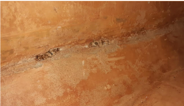
Manque ponctuel de béton ciré
