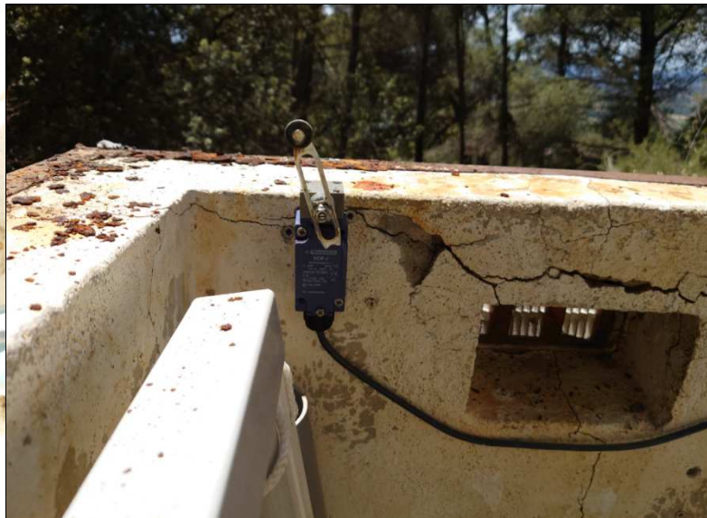
Fissures au niveau de la trappe d'accès à la cuve
