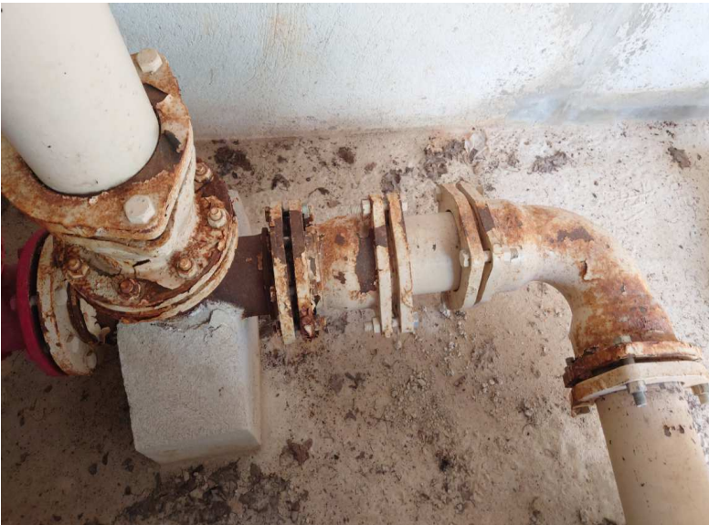
Traces de corrosion sur la canalisation de vidange
