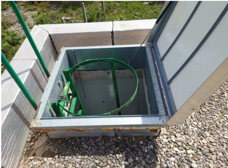
Trappe d'accès à la toiture du réservoir depuis la chambre de vannes
