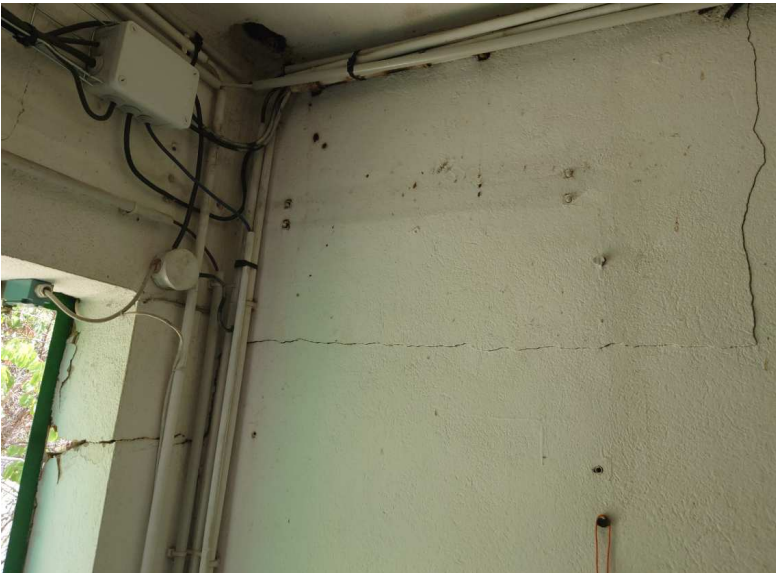
Fissures de la chambre de vannes
