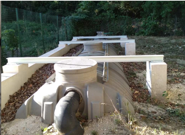
Bâche des eaux de lavage avec rejet dans le réseau d'assainissement
