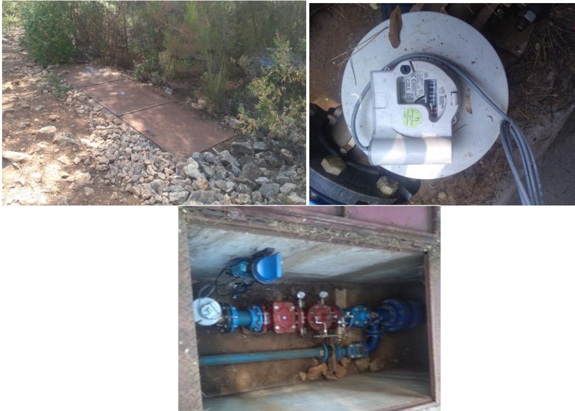
Figure 32 : Canalisation alimentant le Castellet depuis la ZA de Signes
