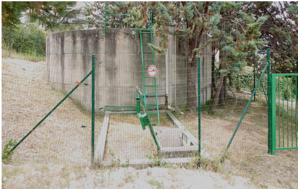
Figure 24 : Vue extérieure du réservoir du Village
