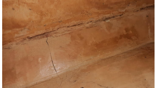
Fissures courant jusqu'au radier
