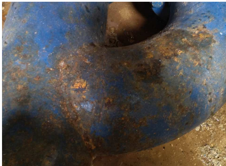
Traces de corrosion sur la canalisation d'alimentation
