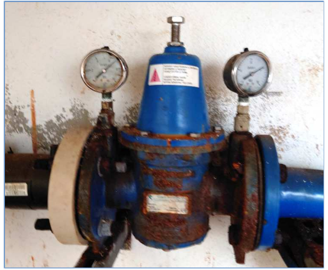
Corrosion d'un équipement
