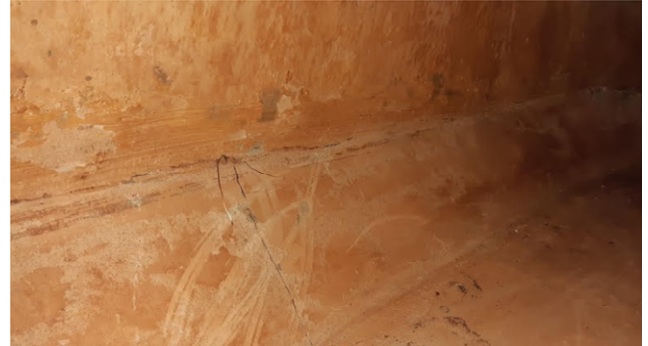
Fissure avec pénétration de radicelle
