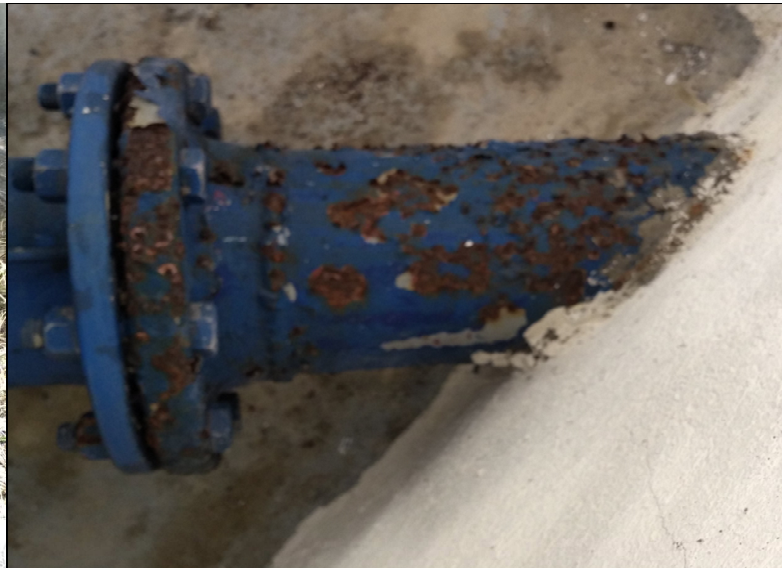
Traces de corrosion de la canalisation vers le réservoir Village
