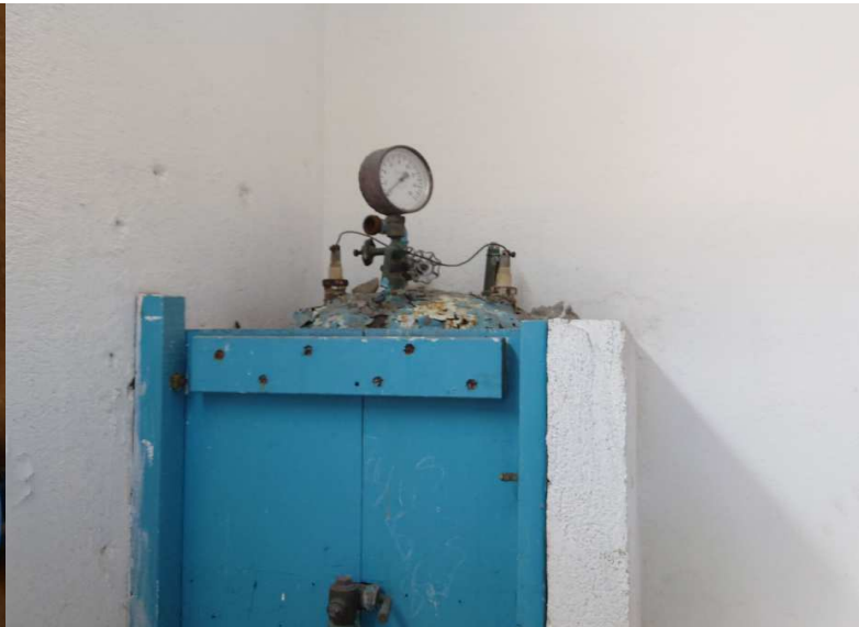
Ballon anti-belier corrodé sur le dessus
