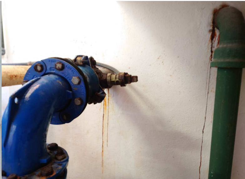
Traces d'humidité de la chambre de vannes
