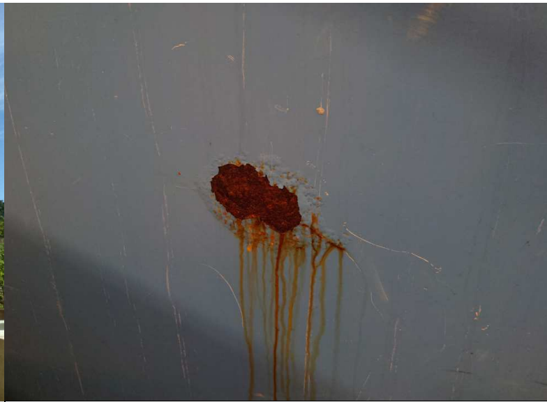
Traces de corrosion du filtre à charbon actif
