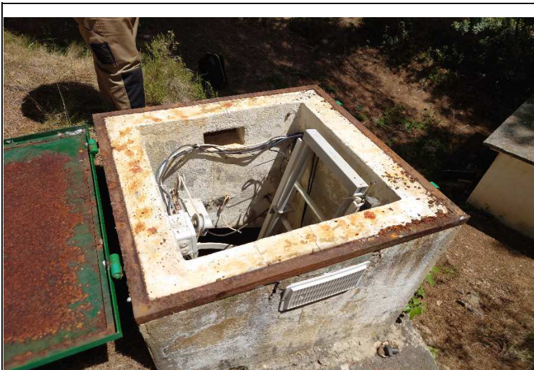
Corrosion importante de la trappe du réservoir (cadre + couvercle)
