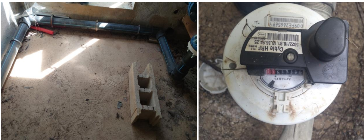
Figure 33 : Canalisation alimentant Cuges-les-Pins depuis la cuve 1 000 m 3 du réservoir du Camp et comptage
