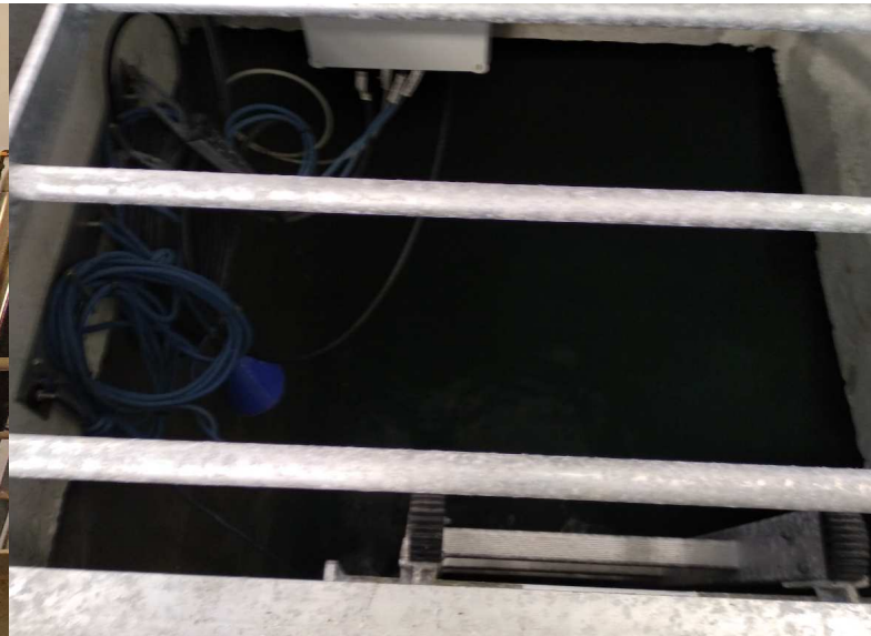
Bâche des eaux traitées par filtration CAG et avant post-chloration
