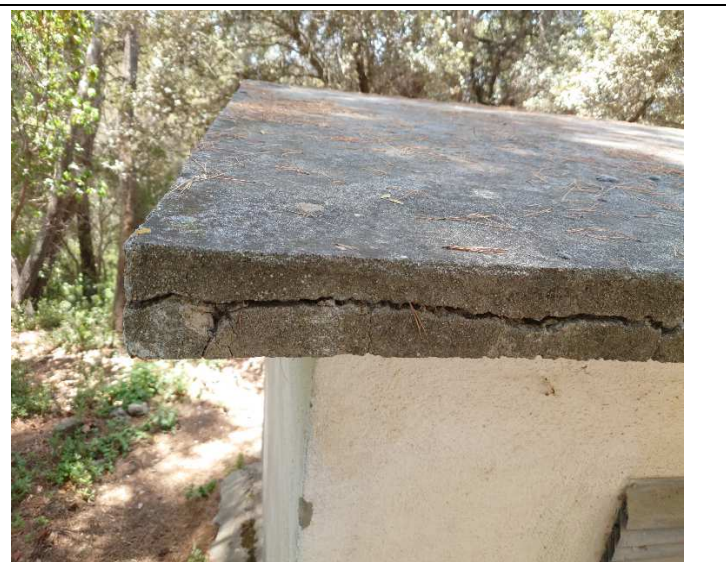
Fissure du toit de la chambre de vanne
